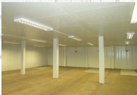
Kisebb méretű csarnok szigeteléssel, világítással
