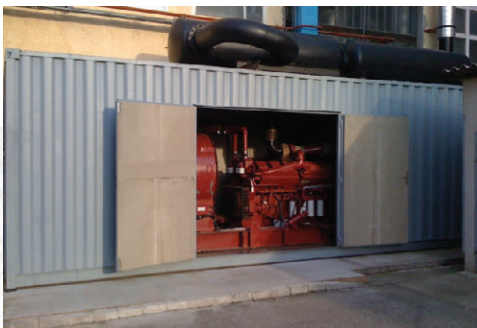
30' konténerben üzemeltetett szivattyúállomás
