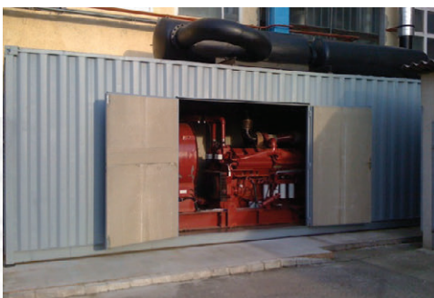
30' konténerben üzemeltetett szivattyúállomás
